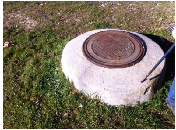
22. Pozo de saneamiento
