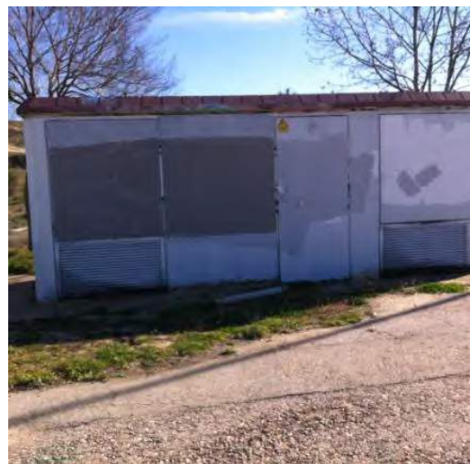
18. Centro de transformación situado en el extremo noreste del recinto
