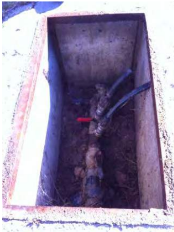
25. Arqueta de abastecimiento
