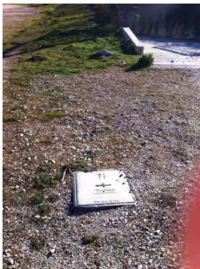
17. Registro de Telefónica junto a rampa de entrada a la estación de transferencia de residuos
