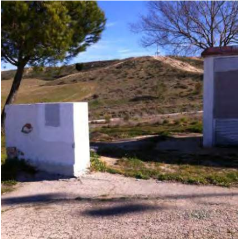
19. Armario eléctrico junto a CT
