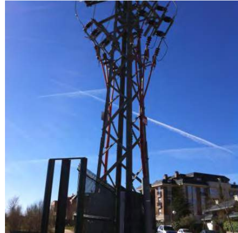
20. Torre de media tensión situada junto al acceso al recinto existente en la intersección de las calles Velero y Urca
