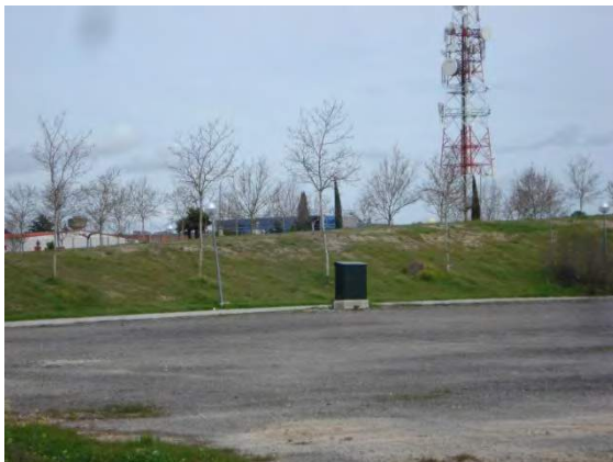
11. Armario eléctrico junto a camino y explanada en la mitad suroeste del recinto
