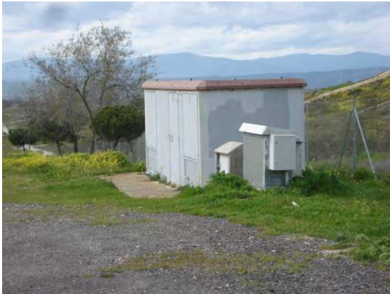
1. Centro de transformación existente en el límite este del recinto ferial
