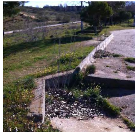
24. Desagüe a cauce
